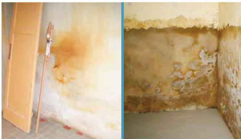
Špatně aplikovaná sanační omítky (plísně, solné výkvěty).
