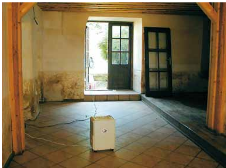
Příklad špatně instalovaného kondenzačního vysoušeče (nevyváženost výkonu přístroje, výšky promočení a objemu místnosti + otevřené dveře, kudy přichází nový, vlhký vzduch).
